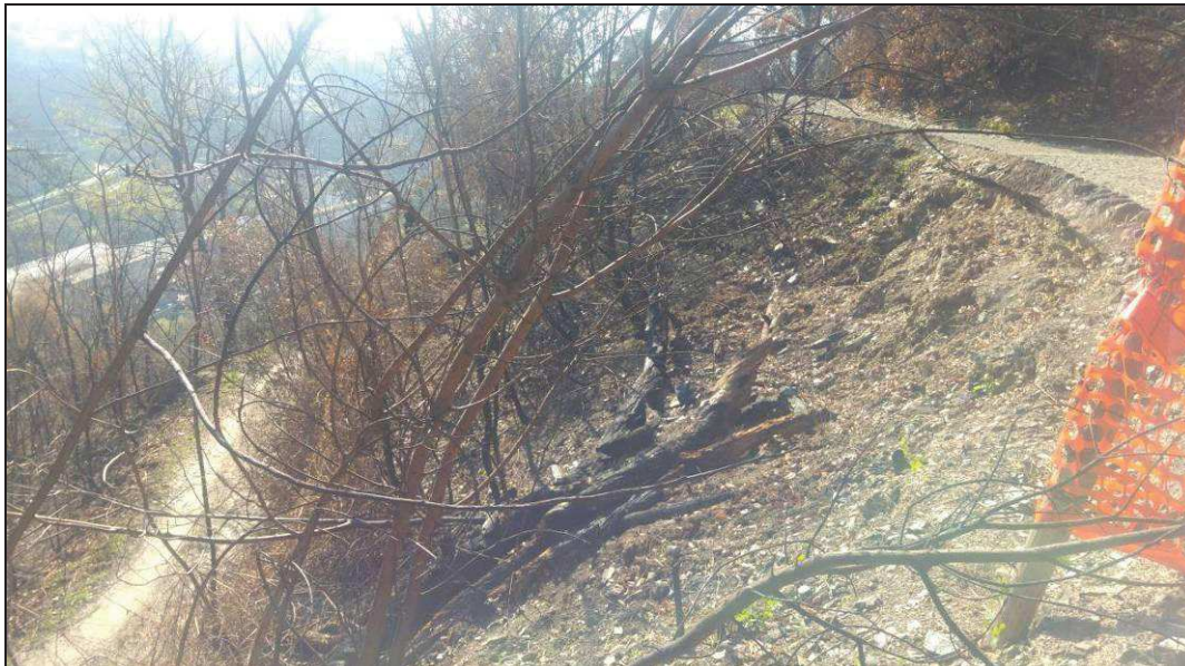
Foto 6: nel settore sottostrada lungo la scarpata in collasso si nota una rottura di pendenza dovuta all'accumulo di materiale mobilitato
