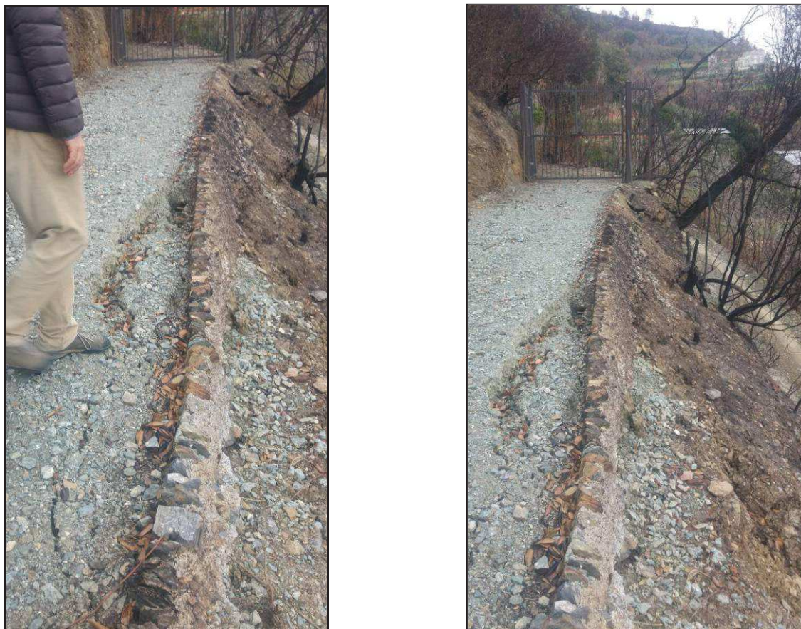
Foto 4: dettaglio del cordolo sottoescavato e progressivo coinvolgimento della carreggiata
