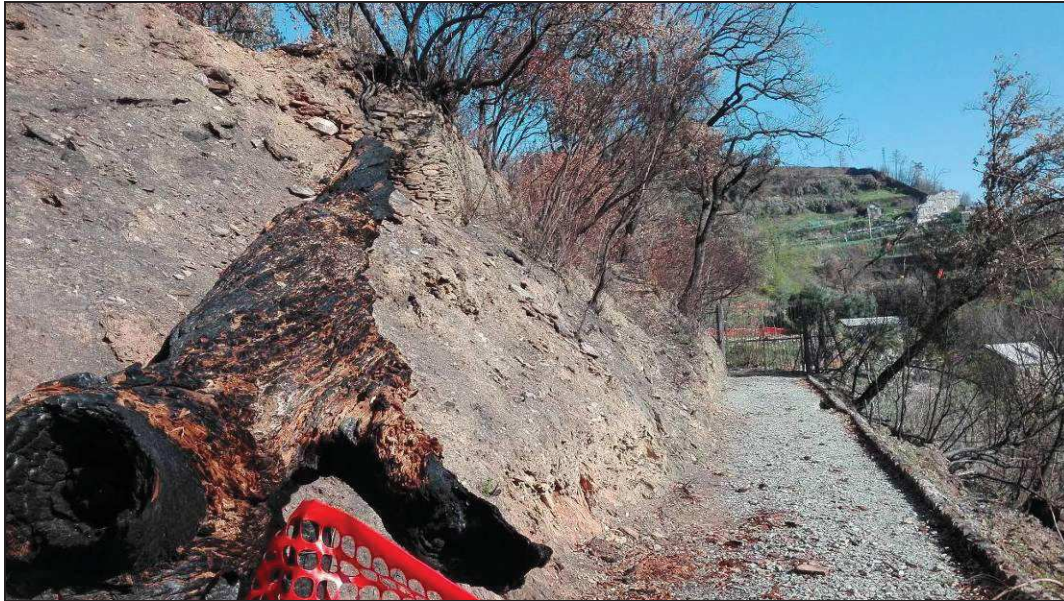
Foto 5: la scarpata a monte del tratto di strada in dissesto si trova in condizioni di erosione e progressivo arretramento per distacco di frammenti e volumi litoidi.
