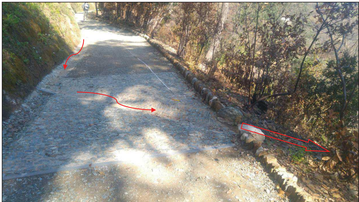
Foto 9: dettaglio della canaletta rompitratta in corrispondenza della quale le acque incanalate si riversano senza alcun presidio nella scarpata sottostante.
